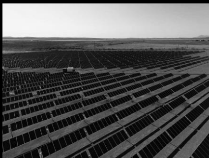
PARQUE FOTOVOLTAICO LOS SANTOS SOLAR I
