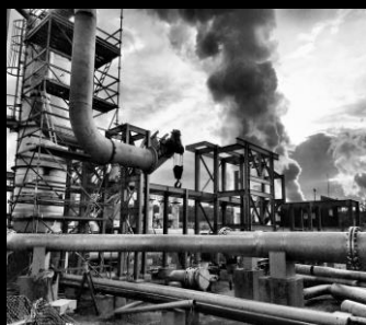
GEOTHERMAL LOS HUMEROS III
